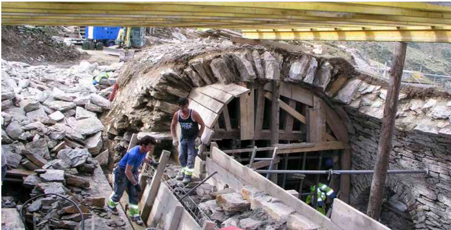
Au cours des onéreux travaux de remise en état, la galerie a été en grande partie démontée et reconstruite.
